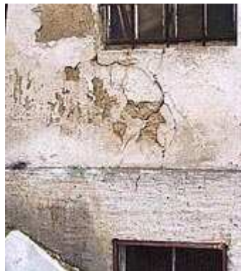
Detailaufnahme Risse und Putzschäden am Giebel im EG
