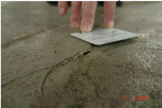
deutliche Risse in der Bodenplatte der TG
