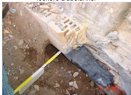
fehlende Gründung Wetterschale (Klinkerfassade)
