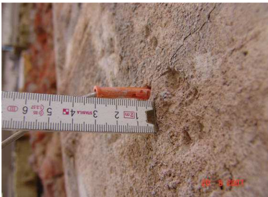
mangelhaft eingesetzte Dübelanker
