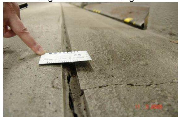
stark gerissene Dehnungsfugen
