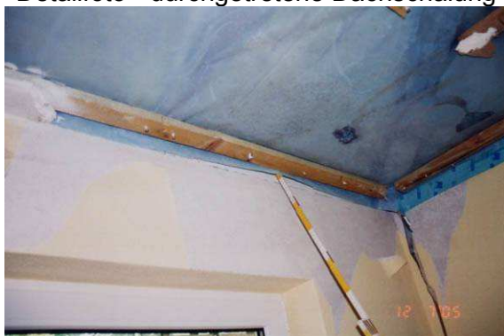
mangelhafter Anschluss der Dampfbremse
