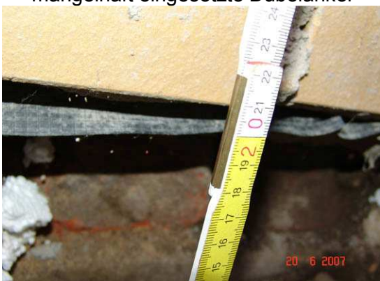
mangelhafte Abdichtung des Fußpunktes
